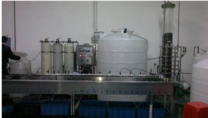
Figura# 3: Sistema purificador de agua industrial
