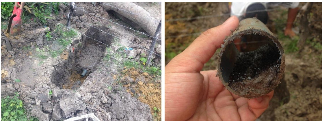
Fotografía 1 Verificación del estado de la red secundaria de 50 mm donde se observa su sedimentación.
