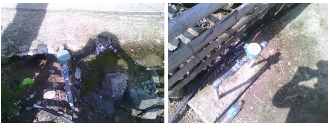
Fotografía 2. Medidores domiciliarios existentes instalados hace más de 25 años que ya no funcionan.
