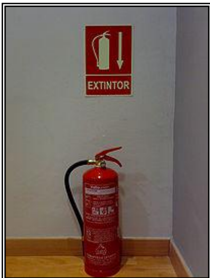
Extintor tipo ABC con cartel indicativo.
