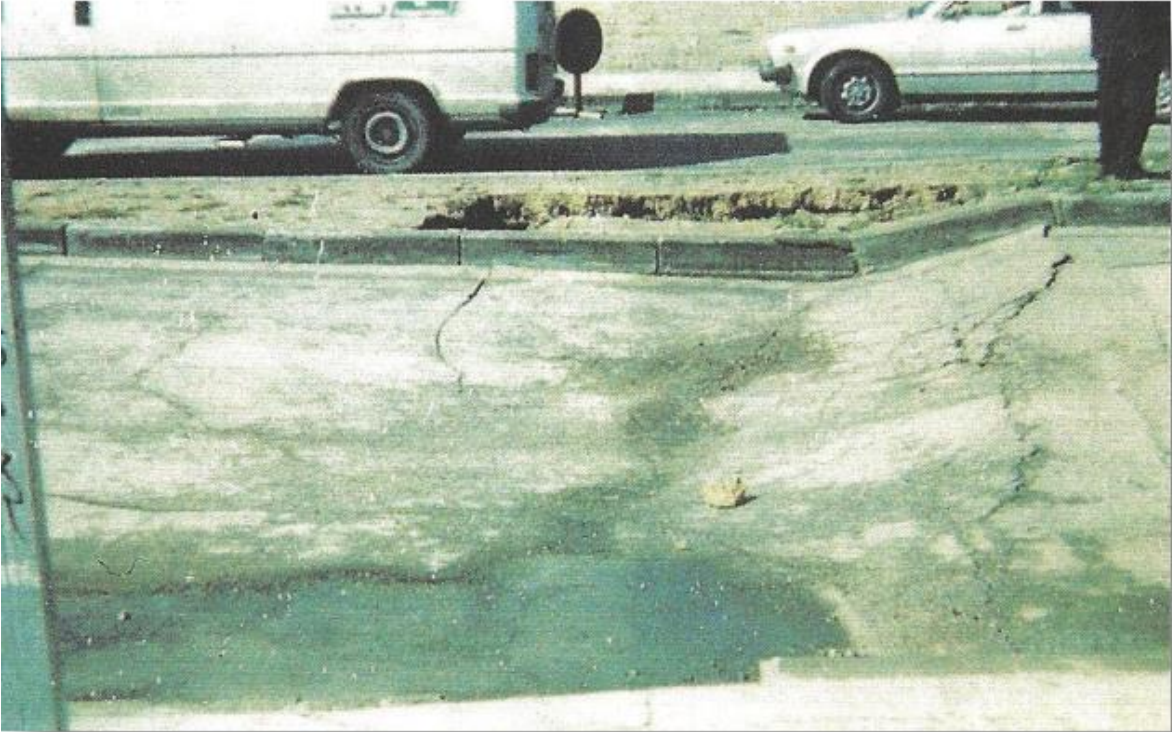
Ilustración 16: Hundimiento de calzada y acera
