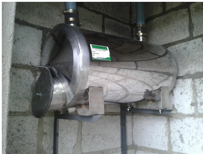
Figura 11. Tanque de balance
