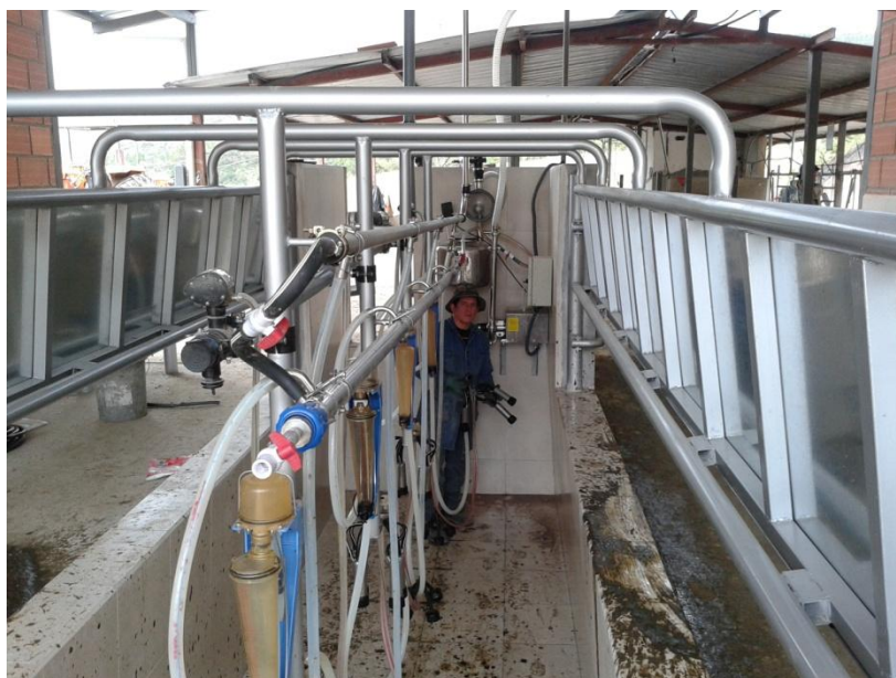
Fuente: Agromantenimiento Cárdenas
